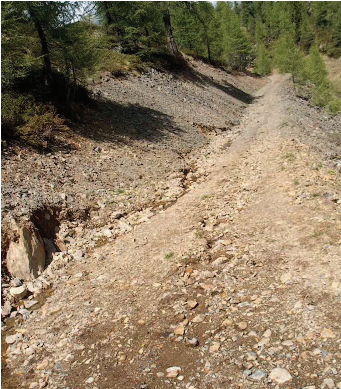
Figura n. 42: strada agro-silvo-pastorale Campelli-Meriggio-San Salvatore, erosione incanalata sul piano viabile e al piede della scarpata di monte.
