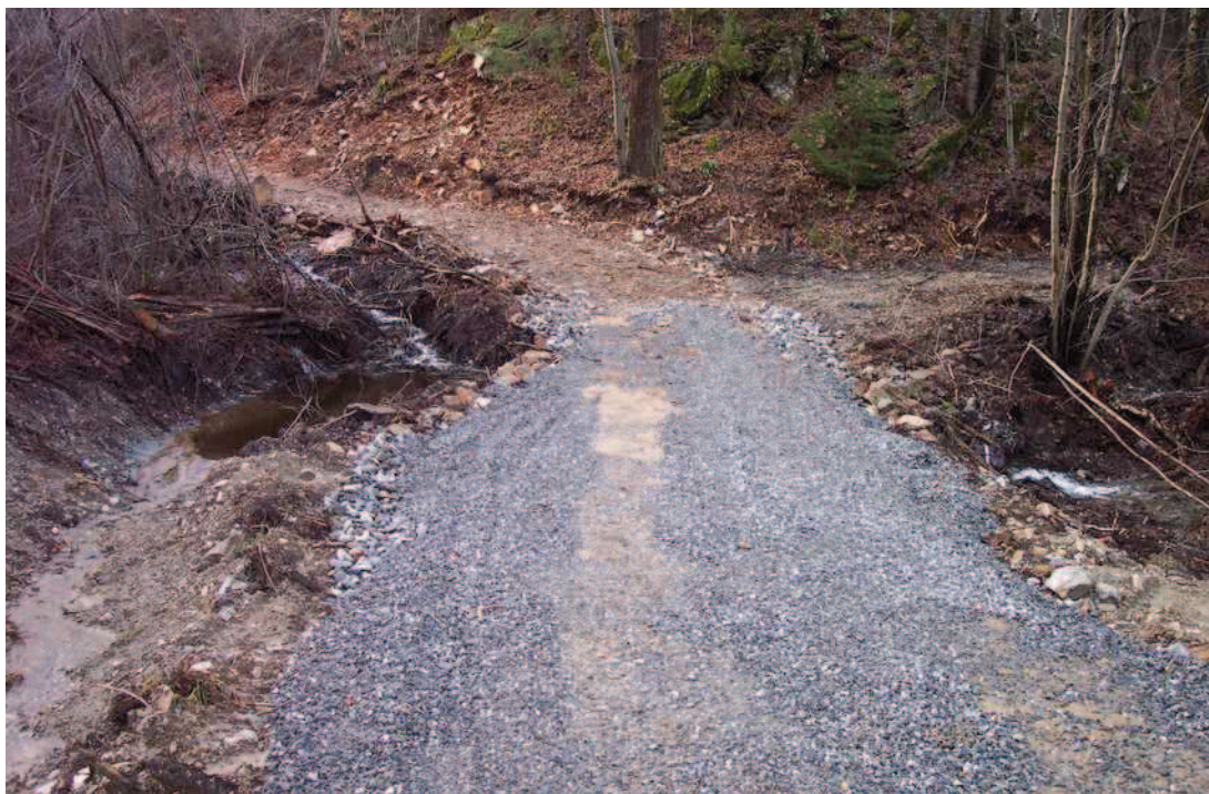
Figura n. 53: strada agro-silvo-pastorale Gandola-Romeri-Paganoni, cunetta di scolo e relativo tombino con stabilizzazione del fondo tramite inghiaatura.
