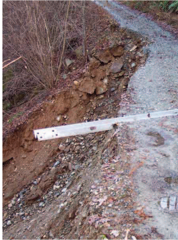
Figura n. 50: strada a.s.p. Gandola-Romeri-Paganoni cedimento della scarpata di valle in prossimità di una canaletta.
