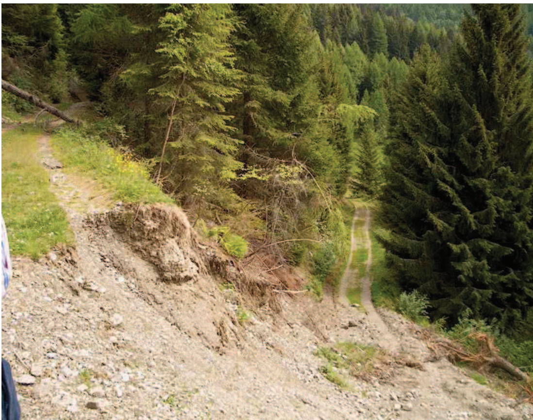
Figura n. 12: viabilità agro-silvo-pastorale Campelli-Meriggio-San Salvatore , franamento della sede stradale in prossimità di un tornante (alluvione 2002).
