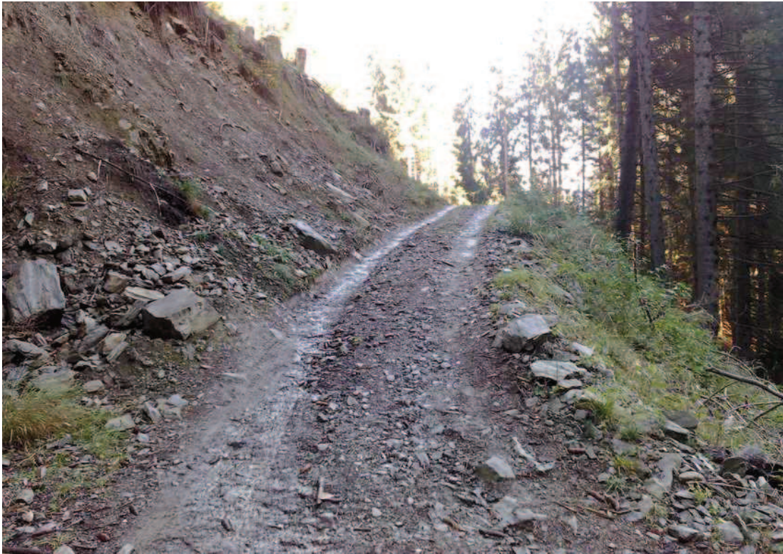
Figura n. 38 : strada agro-silvo-pastorale Barbabrusa-Campeglio, erosione del fondo stradale.
