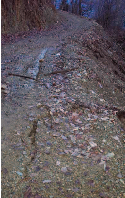
Figura n. 49: strada a.s.p. Gandola-Romeri-Paganoni segni di cedimento della scarpata di valle a causa della saturazione del terreno.
