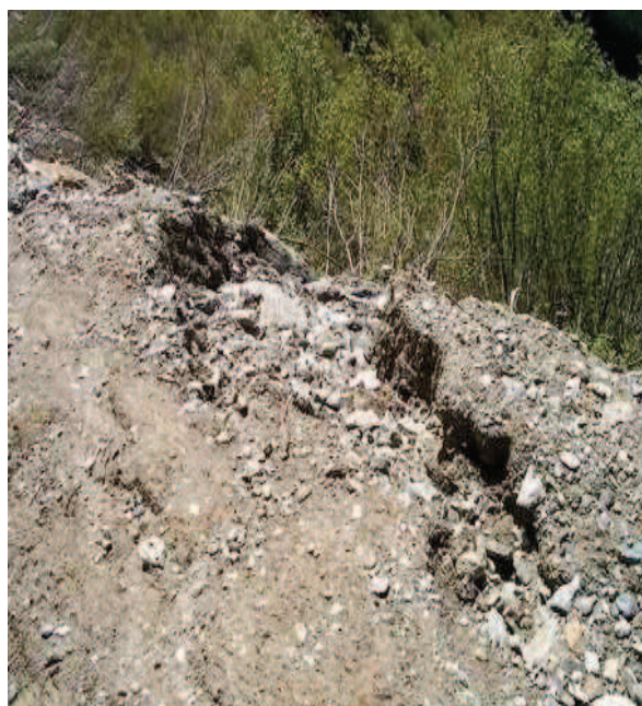
Figura n. 44: strada a.s.p. Campelli-Meriggio-San Salvatore, erosione incanalata della sede stradale in corrispondenza dello sbocco sulla scarpata di valle
