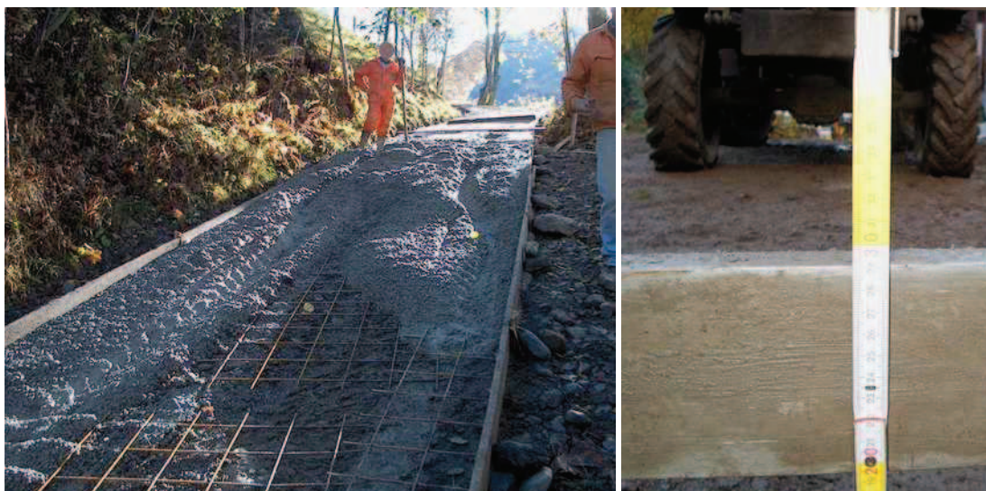
Figura n. 54 e 55: strada agro-silvo-pastorale Campelli-Meriggio-San Salvatore, lavori di pavimentazione in battuto di cemento armato con rete elettrosaldata.
