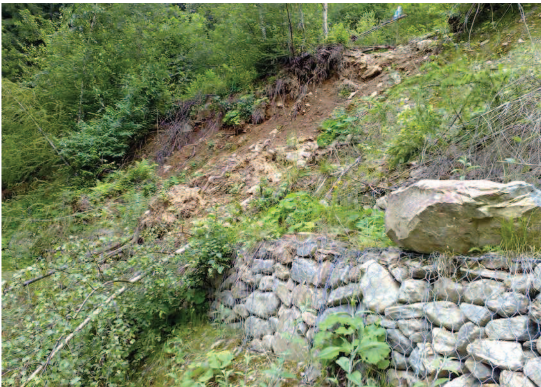
Figura n. 39: piccolo dissesto sotto il tornante in loc. Ca Olt in comune di Caiolo. Si noti come il franamento non abbia interessato il tratto di scarpata consolidato dal gabbione.
