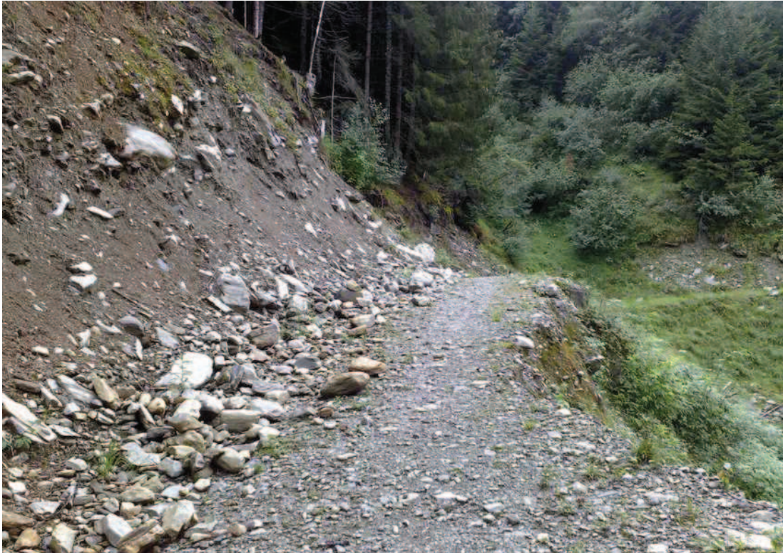
Figura n. 35: strada agro-silvo-pastorale Barbabrusa-Campeglio in comune di Caiolo, dissesti (2007)
