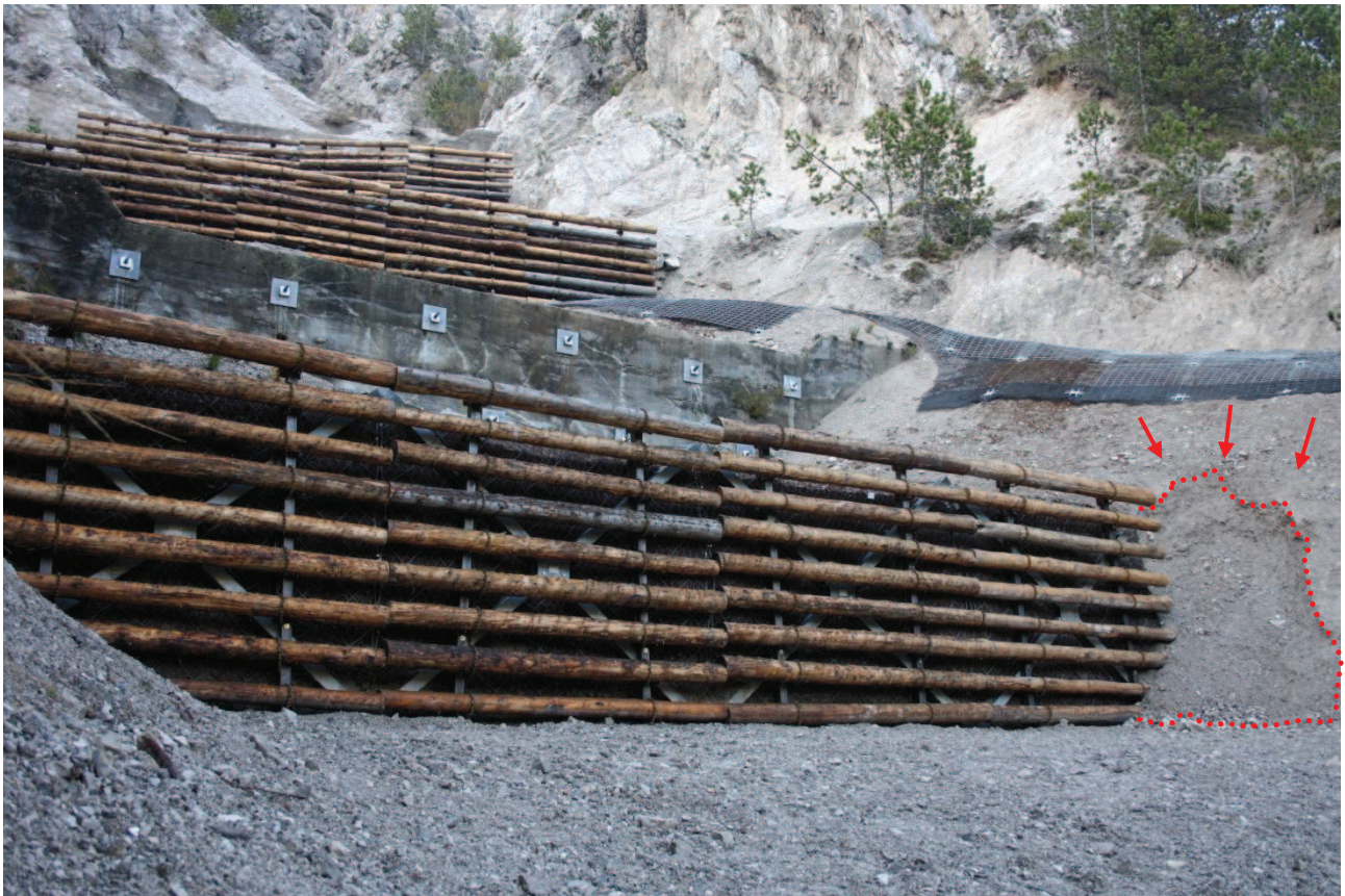
Figura 71. In evidenza è possibile vedere la zona che presenta un accentuato franamento di materiale.
