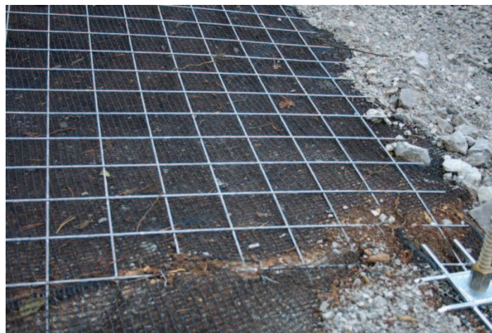
Figura 61. Particolare del rivestimento superficiale che mette in evidenza il sottostante terreno colturale ed il sistema di fissaggio delle reti elettrosaldate.
