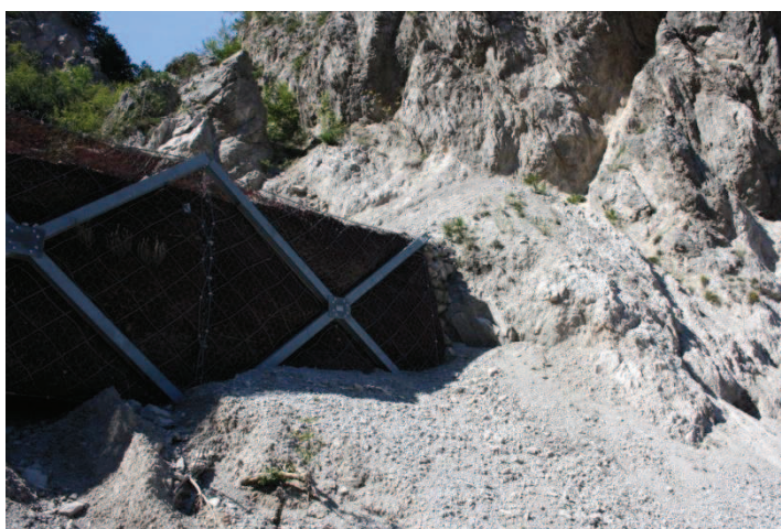
Figura 53 e 54. Fenomeno di erosione al piede del pannello consolidatore Erdox.
