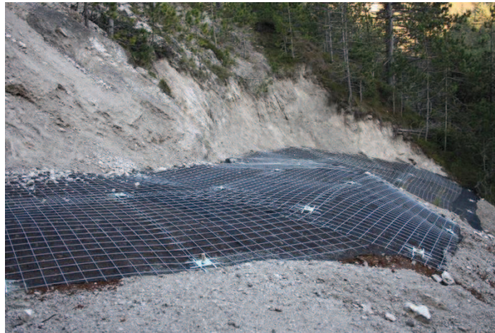
Figura 60. Rivestimento antiersivo nella parte alta del bacino, sulla sinistra orografica del Torrente Bertone.
