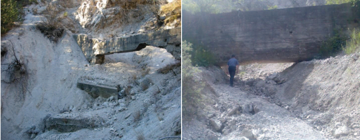
Figura 49 e 50. Briglie realizzate dal CFS negli anni '60 con fenomeni di cedimento strutturale e sottoescavazione.
