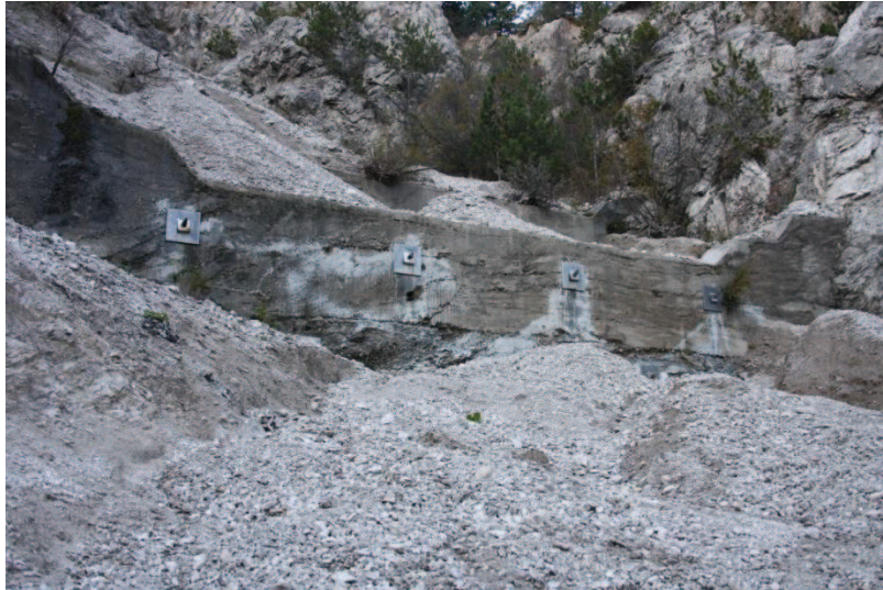
Figura 75. Briglie in CLS, sovrastanti i pannelli Erdox, che risultano eccessivamente sovralluvionate
