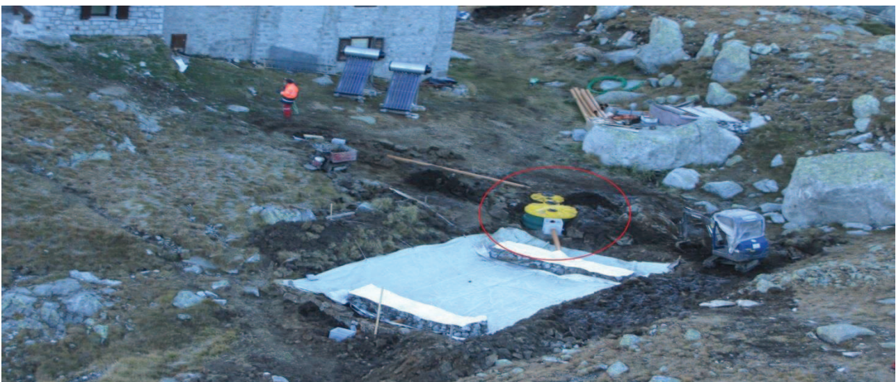
Figura 47: Immagine dell'impianto al Rifugio Tonolini: nel riquadro rosso si notano i sistemi di sedimentazione primaria con a monte il degrassatore e più a valle la vasca Imhoff; fonte: Parco dell'Adamello
