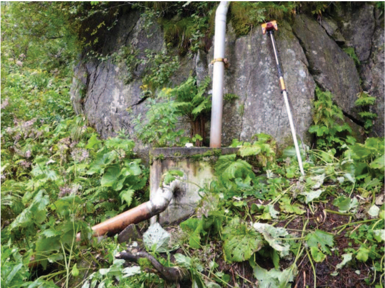
Figura 59: Vasca imhoff prefabbricata attualmente in uso presso il rifugio Aviolo; (fonte: Parco dell'Adamello)
