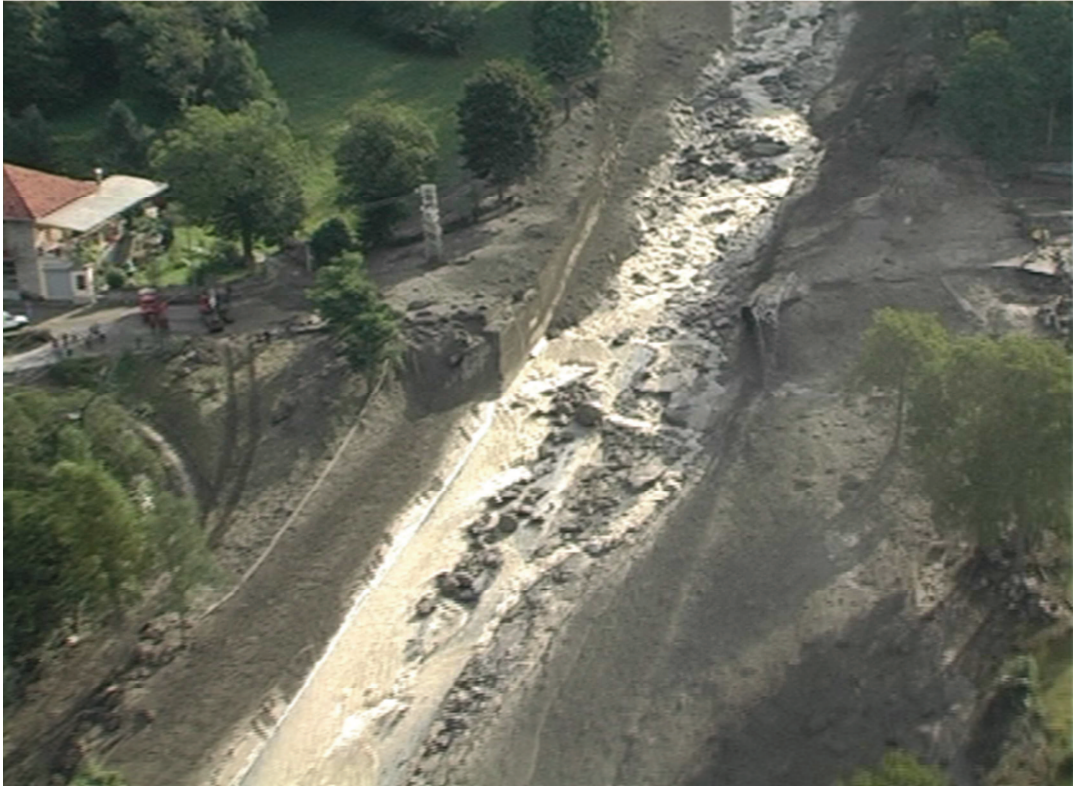
Figura 41: foto di quel che rimane del ponte in seguito al passaggio del debris flow.
