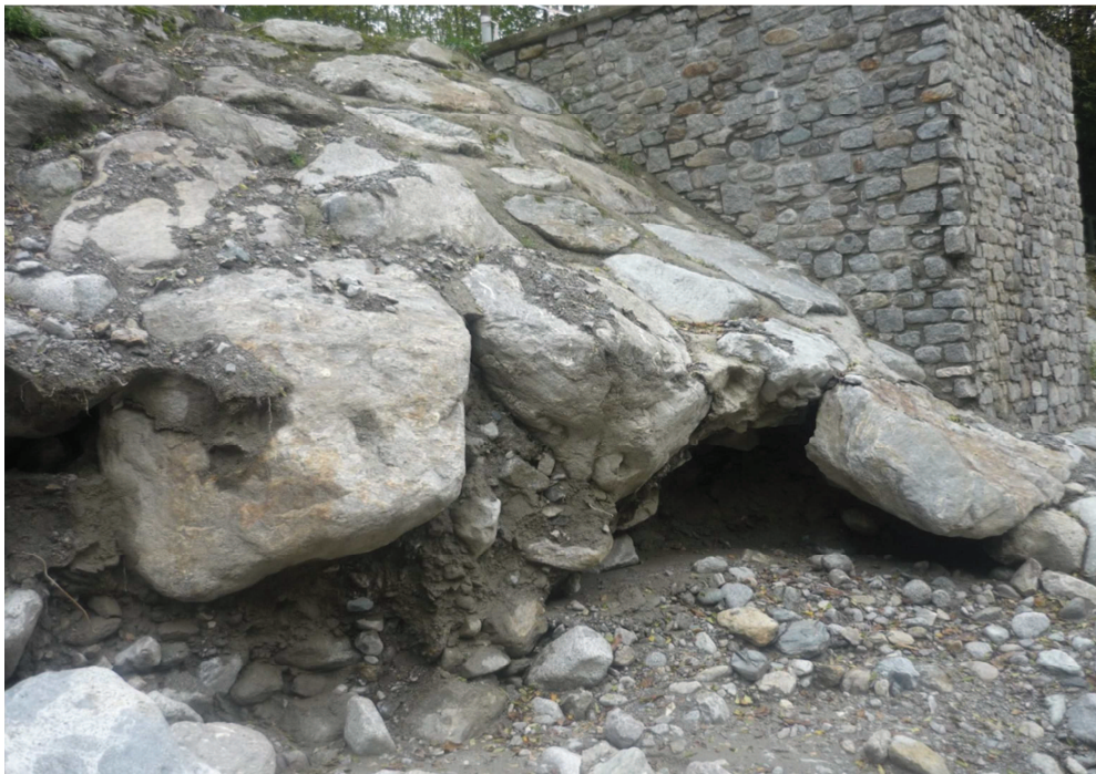
Figura 56 : erosione del piede di sponda generata dalla colata.
